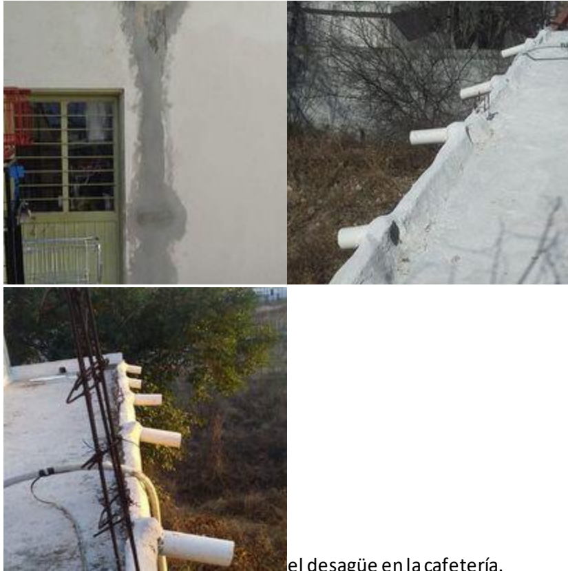
el desagüe en la cafetería.
